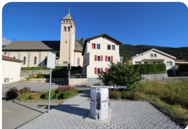
Bornes de recharge à Erde
